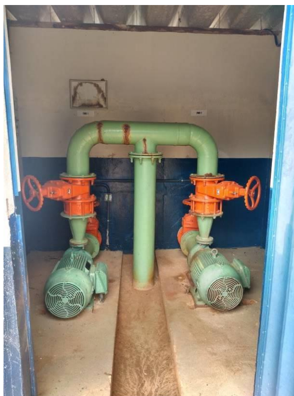
Foto 15 – Estação Elevatória de Água Tratada – ETA
